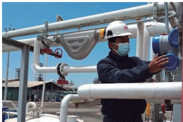
PUESTA EN MARCHA DE FLUJÓMETROS MÁSICOS CORIOLIS - AGROINDUSTRIA
