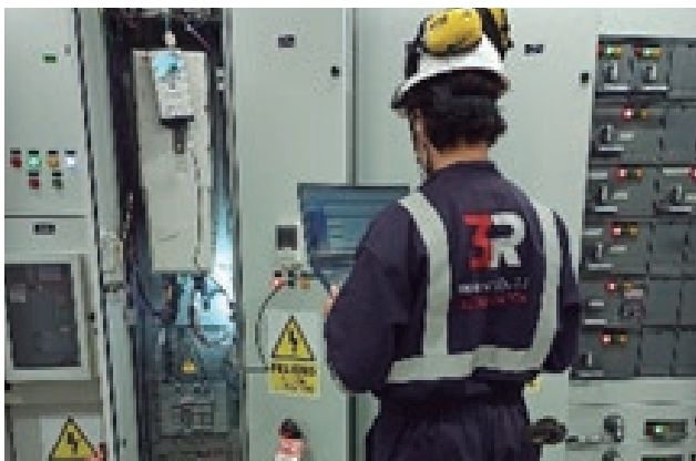
DIAGNÓSTICO DE REDES PROFIBUS EN SALAS ELÉCTRICAS - MINERIA
