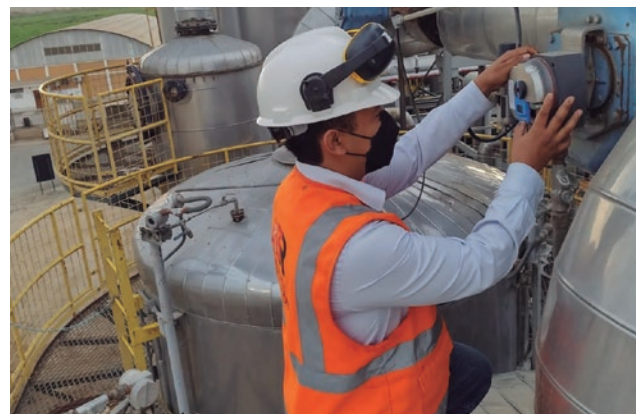
DIAGNÓSTICO Y MANTO DE VÁLVULAS DE CONTROL
