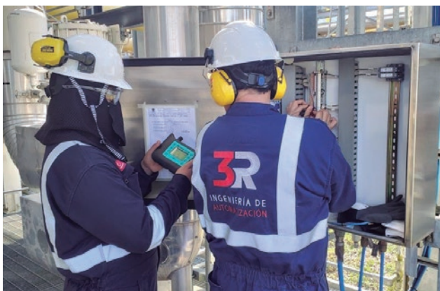
AUDITORIA Y DIAGNÓSTICO DE REDES FOUNDATION FIELDBUS - PLANTA DE GAS
