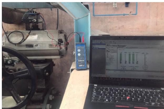
DIAGNÓSTICO DE POSICIONADORES INTELIGENTES PLANTA DE TRATAMIENTO DE AGUA
